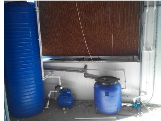
Подключение системы охлаждения к подкулингам
