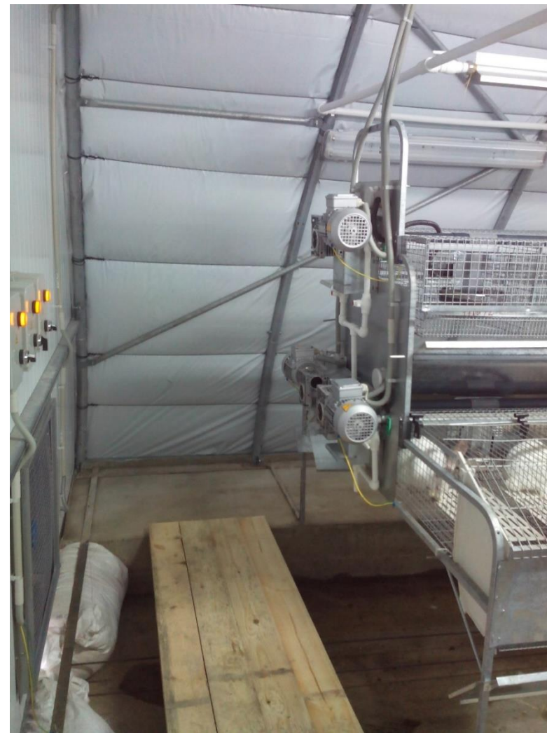
Щиты управления и мотор редукторы продольной АРК
